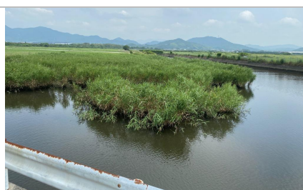
王喜西排水機場遊水池：土砂堆積
