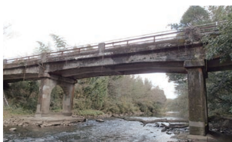
老朽した橋梁
