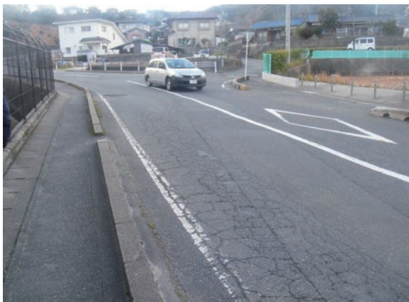
老朽した道路
