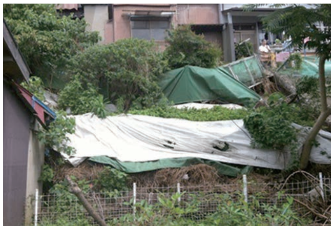
崩壊の危険がある急傾斜地
