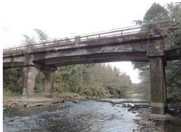
老朽した橋梁
