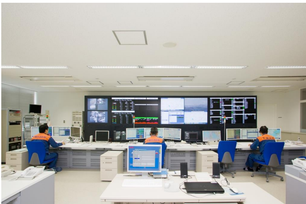
下関市・美祢市消防指令センター
