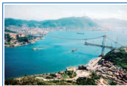
▲1971年12月に撮影された工事の様子。車道部分は両側の主塔から作られました。
