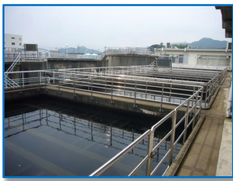
長府浄水場 急速ろ過池
