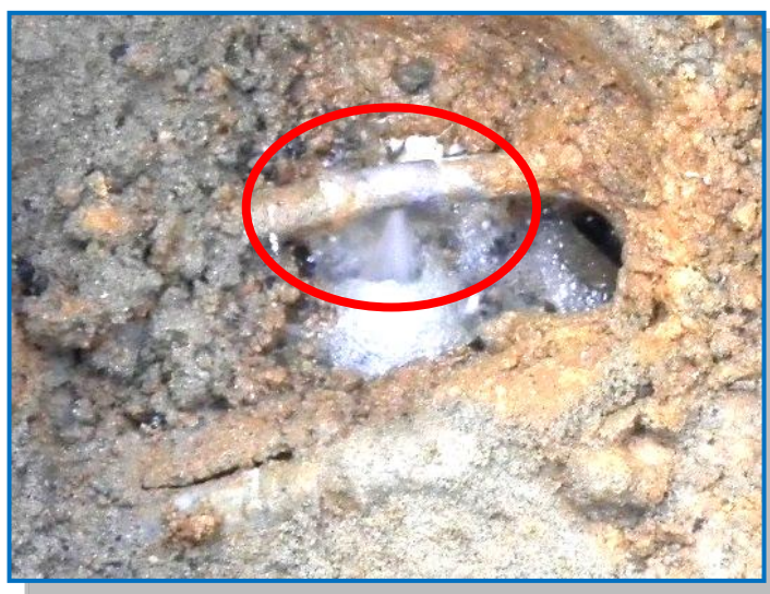
鉛製給水管漏水箇所
