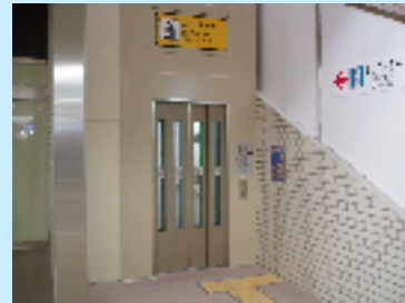
車いすの向きを変えずに乗降できるエレベーター
