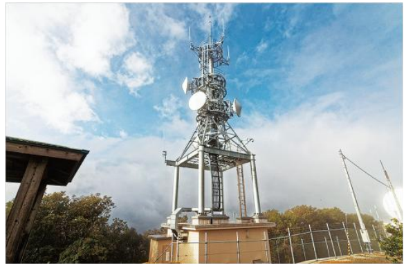
華山無線基地局鉄塔
