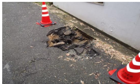
陥没した道路舗装
