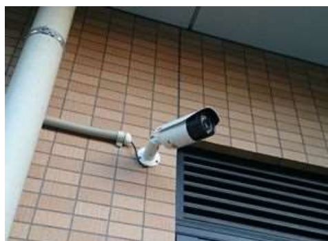
防犯カメラの設置例
