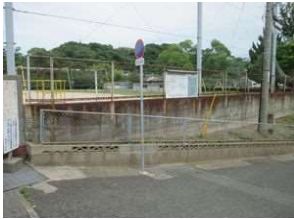
危険ブロック塀 撤去前（小学校）
