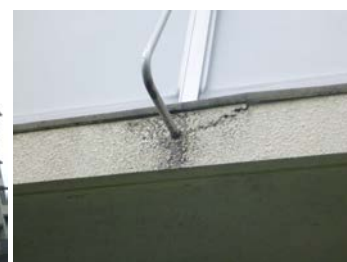
宝改良（劣化箇所）
