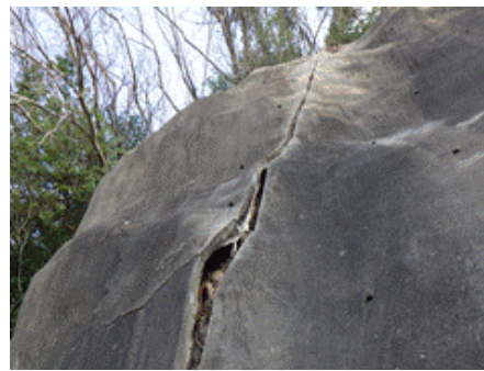
法面ひびわれ箇所
