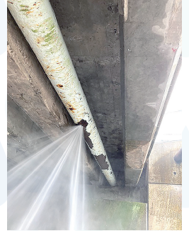
橋の下部に取りつけた配水管が老朽化により破損した様子 令和3年8月
