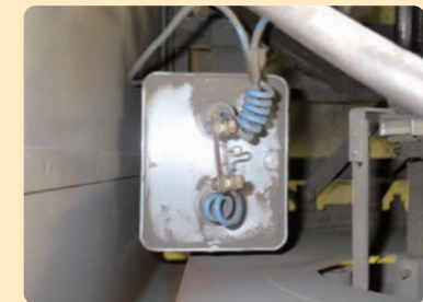
電気溶接機の内部に取り付けられた 低圧コンデンサー
