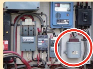
低圧分電盤内の 低圧コンデンサー
