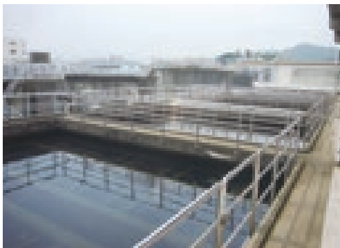
長府浄水場急速ろ過池
