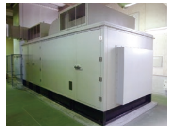
自家発電設備(ガスタービン発電機)
