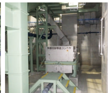
外部沈砂移送コンベヤ
