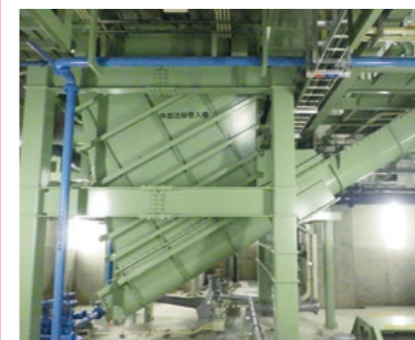
外部沈砂受入槽
