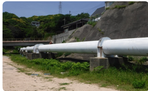
長府浄水場～長府配水場間送水管（昭和41年布設）
