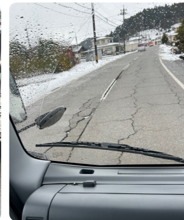
亀裂の入った道路
