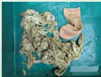
下水道のポンプに詰まったウェットティッシュ等
