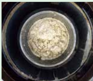
下水道管に詰まった油脂
