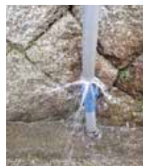
※漏水している様子
