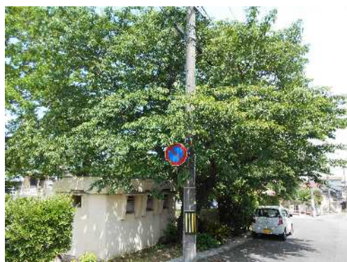
電線や建物への接近 (神田町1丁目付近)
