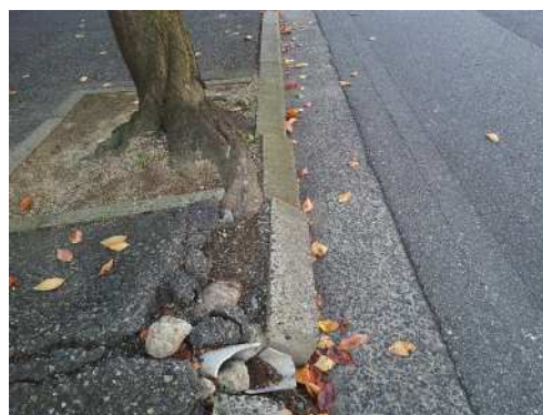
舗装の破壊(宮田町付近)
