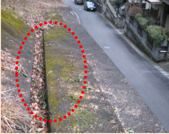
擁壁の上にある排水溝の詰まり
