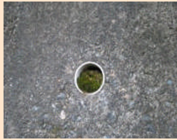
水抜き穴の詰まり
