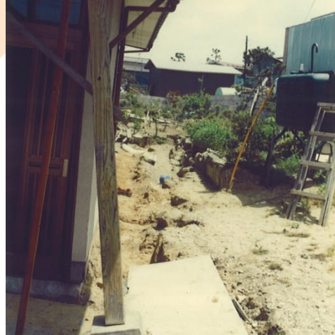
液状化による住宅の傾き
