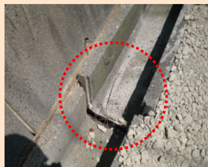
側溝の継目のずれ
