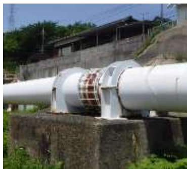
老朽化した送水管（水道）
