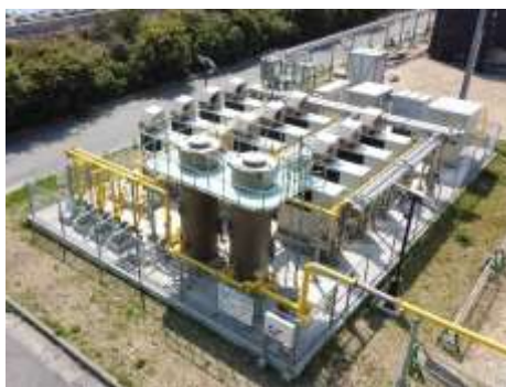
山陰終末処理場消化ガス発電事業
