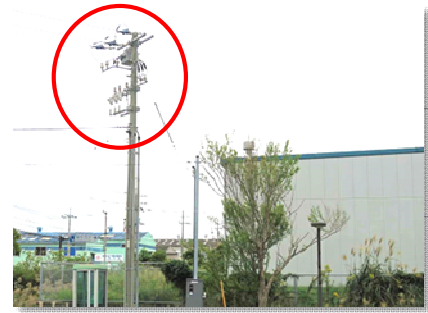
高圧気中開閉遮断器
