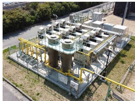
山陰終末処理場消化ガス発電事業
