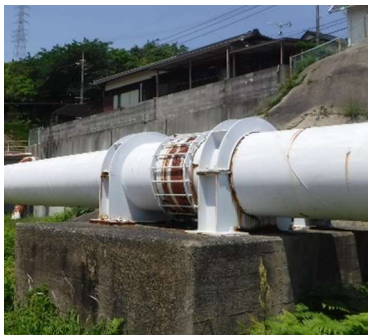
老朽化した送水管
