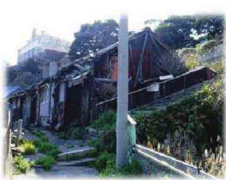
危険な空き家
