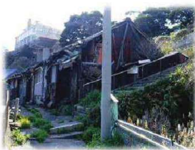
危険な空き家
