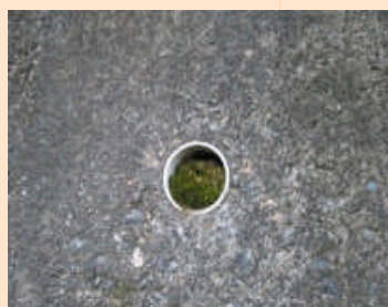
水抜き穴の詰まり
