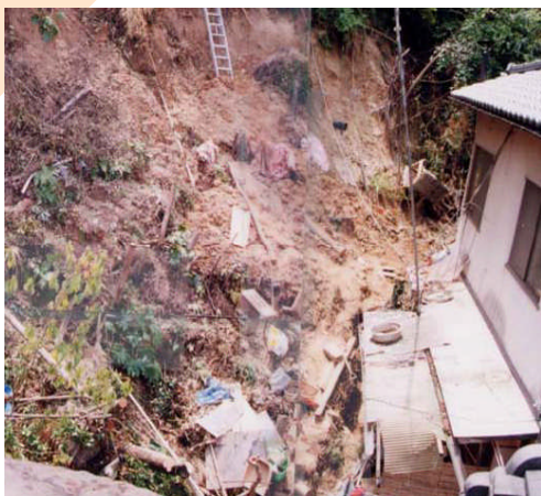
がけ崩れによる住宅被害
