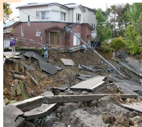
盛土の滑動崩落による宅地被害
