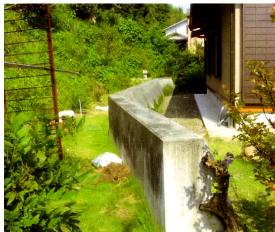
待ち受け擁壁の設置例
