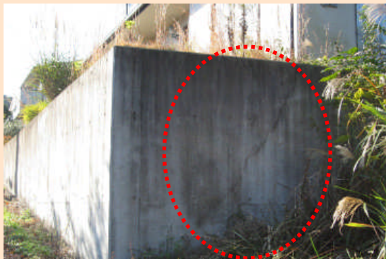
コーナー部でのひび割れ
