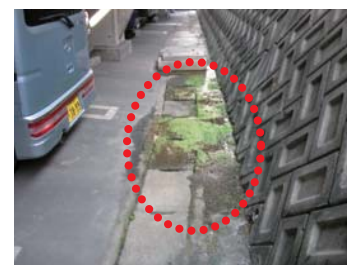
湧水部分にコケが生えている擁壁
