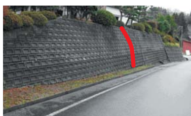
擁壁下端のハラミ出し
