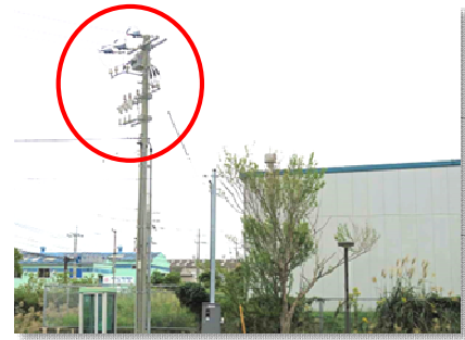
高圧気中開閉遮断器
