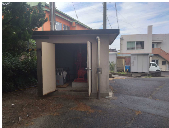
消火ポンプ室
